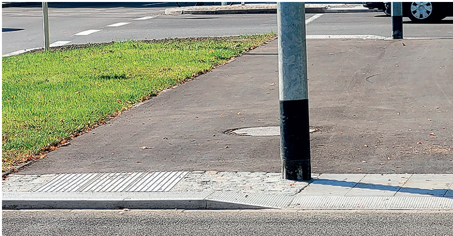
Bordsteinkanten mit unterschiedlichem Niveau: Eine klare Markierung der Aufstellflächen an den Ampeln ist wünschenswert.
