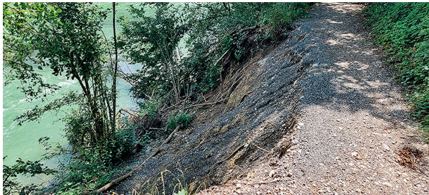
Schwachstelle: Das ist die Stelle, wo etwa die Hälfte des Radweges weggerutscht ist – jetzt nicht mehr gefahrlos zu befahren.
